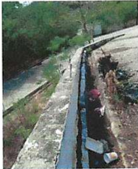
Foto 1: Necesidad de muro perimetral en el establecimiento
