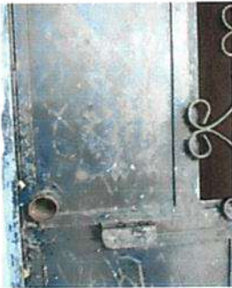
Foto 3: Puerta sin Chapa en el establecimiento
