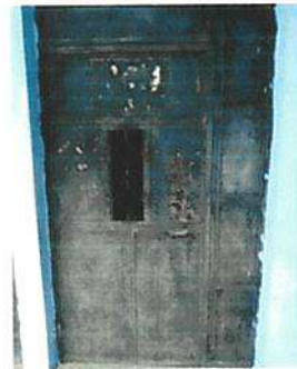
Foto 4: Estado actual de las puertas en el establecimiento.
