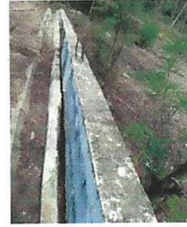
Foto 2: Estado actual de muro perimetral en el establecimiento.
